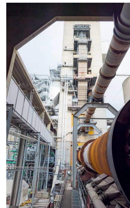
Der grosse Drehrohrföhrer und im Hintergrund der Wärmetauscherturm
