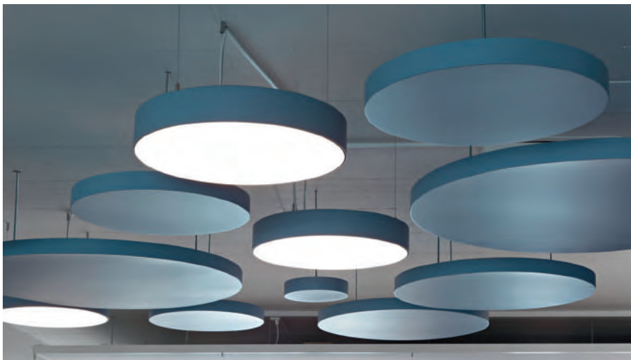
Akustik-Decke: Tomeo; Leuchte: Lumeo (Foto: Oliver Kern).
