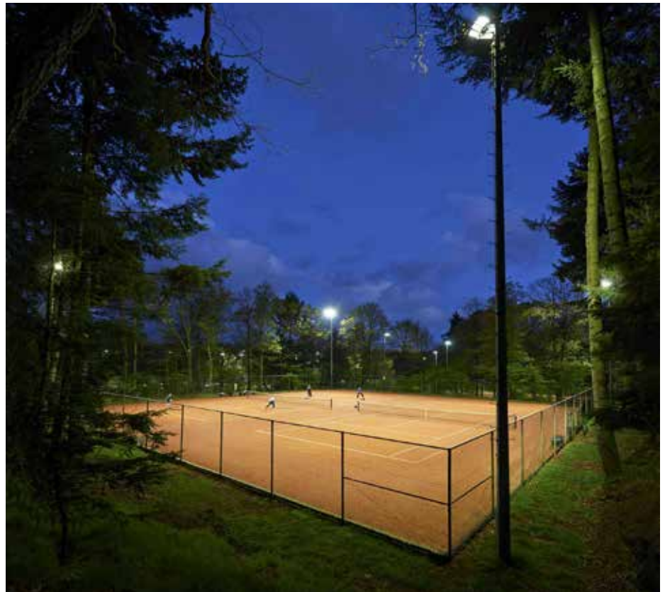
Professionelle Beleuchtung eines Tennisplatzes.
