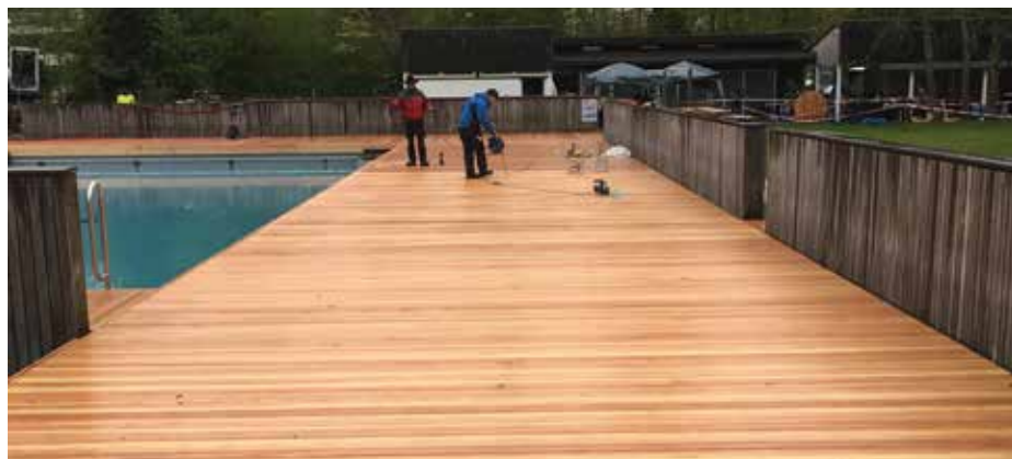
Auch so etwas können die Holzprofis aus Niederlenz: neuer Holzrost in der Biobadi Biberstein.
