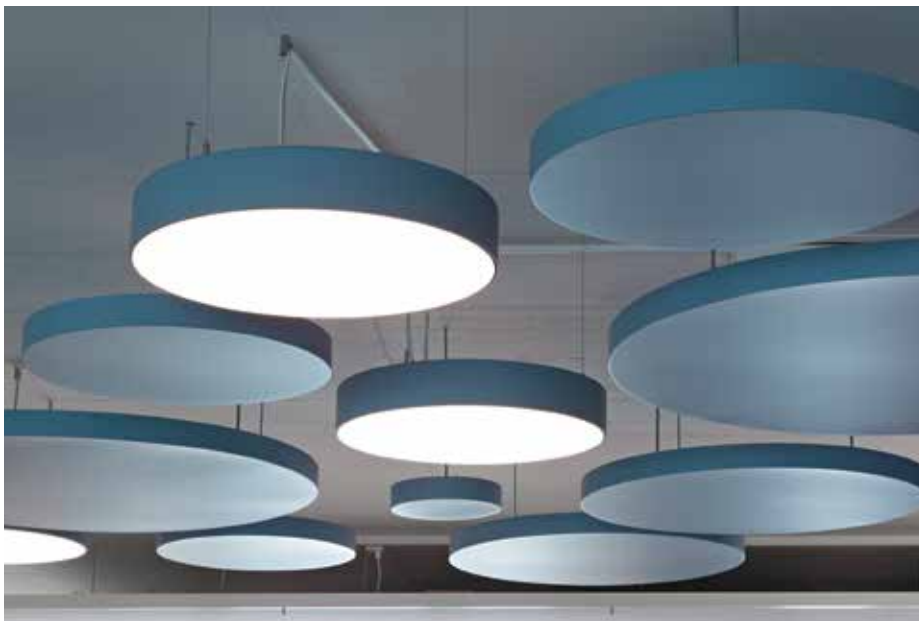
Akustik-Decke: Tomeo, Leuchte: Lumeo (Foto: Oliver Kern).
