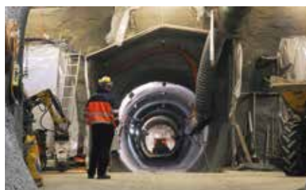
Die Forschung in Felslabors hilft, sichere Standorte für Tiefenlager zu finden und deren bautechnische Machbarkeit zu testen.
