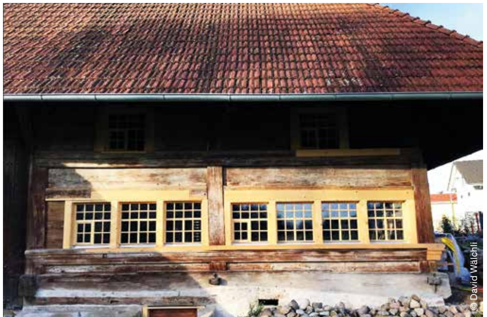
Neuer Fensterwagen, bestehend aus sieben Einzelfenstern
