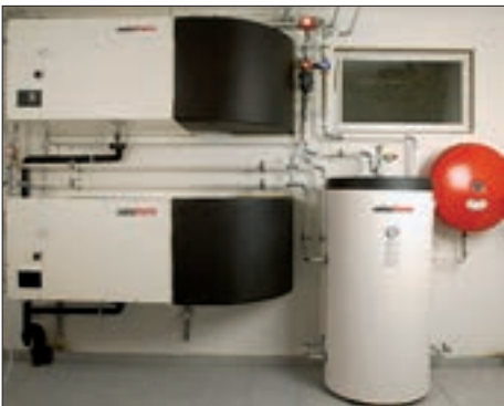
Beispiel einer Wärmepumpe
