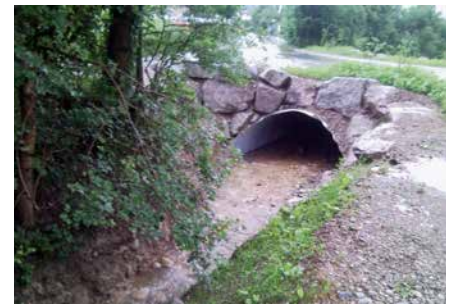
Solide geplant und umgesetzt: Diese Bach-Strassenunterquerung entstand im Ingenieurbüro Senn AG am Computer – sie passt perfekt.
