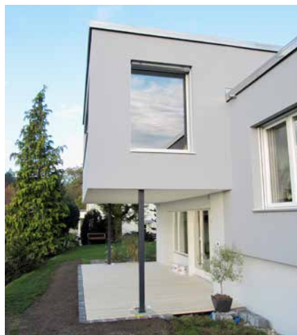
An- und Umbauten – Bei diesem Objekt in Rombach wurde ein alter Betonbalkon demontiert und das bestehende Zimmer vergrössert. Unter dem Anbau ist Platz für einen gemütlichen Sitzplatz.
