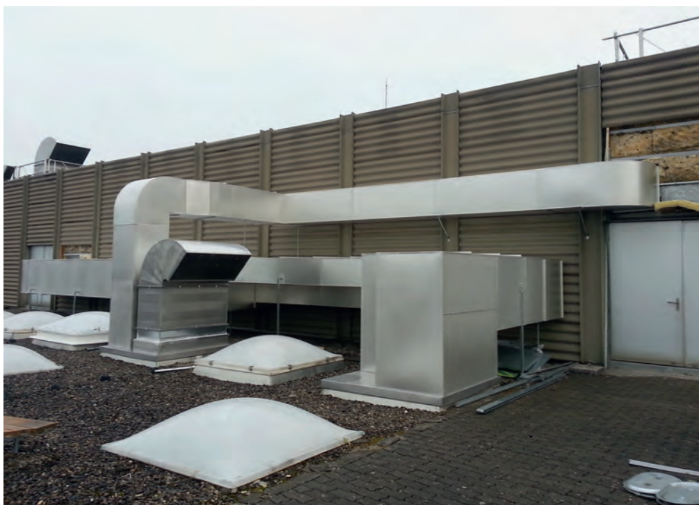
Thermische Dämmung Lüftungskanal mit Alublechummantelung.
