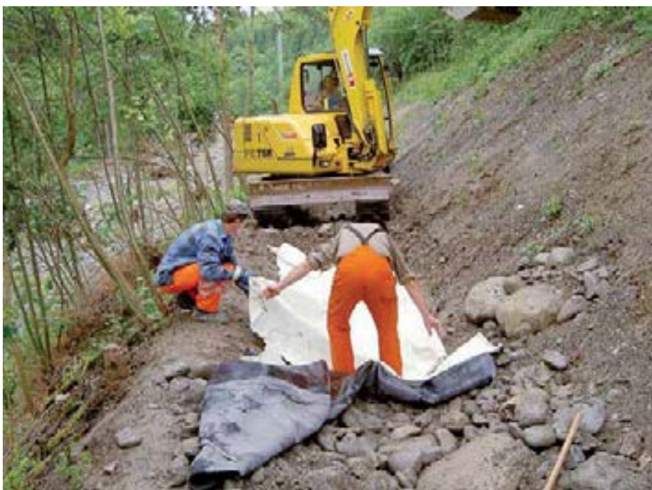
Bachlauf auf der Berme, wo eine Abdichtung mit Vlies und Folien erfolgte
