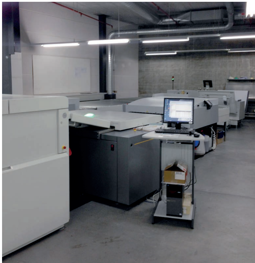
Elektro Dübi war für die gesamte Stromanlage dieser Druckerstrasse verantwortlich.
