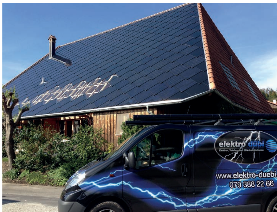
In Hünenberg/ZG wurde eine 80 kWp AC netzgekoppelte Photovoltaikanlage montiert, samt der gesamten AC- und DC-Installation.
