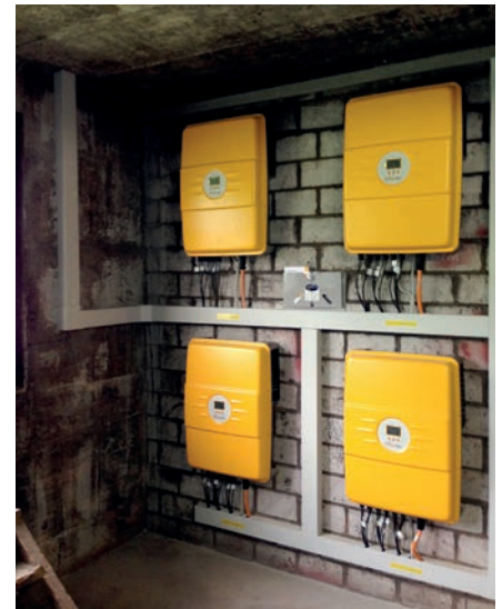
Auch in Brüttern waren die Fachleute von Elektro Dübi gefragt. Bei dieser Photovoltaikanlage wurde zudem die separate Energiemessung für die Rücklieferung ins EW-Netz installiert.
