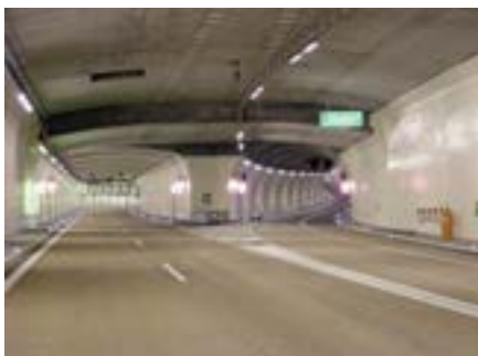
Ein modernes Tunnelsystem verfügt über eine Vielzahl von Sensoren und Steuerelementen. (Im Bild der Kirchenwald-/Loppertunnel)
