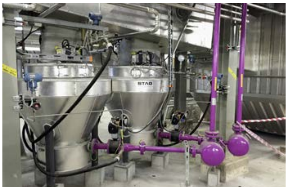
Eine weitere Kernkompetenz der STAG: Pneumatische Dichtstromförderung mittels Schubsender, in dieser Anwendung zur Entaschung des Elektrofilters der KVA Luzern
