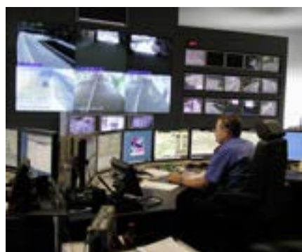
Mit den Systemen von ACG Autcomp Grischa AG die Sicherheit im Tunnel gewährleistet.
