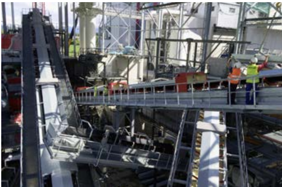
Montagearbeiten in der Triage bei der KEZO in Hinwil. Hier findet die Fraktionierung der Trockenschlacke statt.
