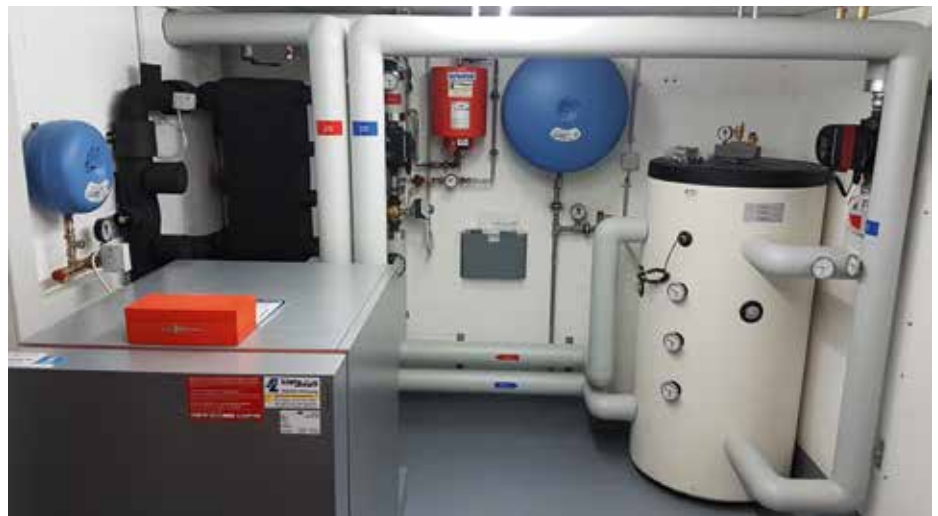
Sanierung mit Wasser- Wasserwärmepumpe 35 kW mit FU regulierter Grundwasserpumpe. (3 Heizungen sind daran angeschlossen)
