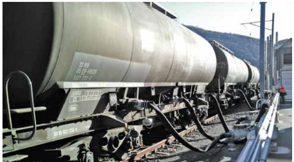
Die Bindemittel-Umschlagsanlage am Ceneri Tunnel in Sigirino
