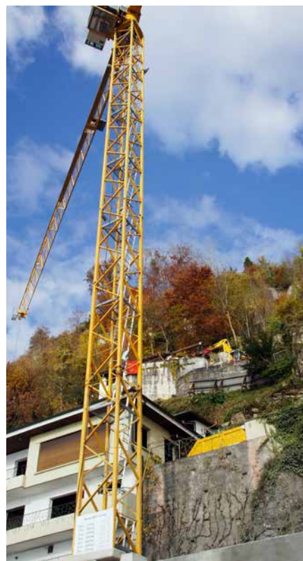
Die Bagger zum Häuser-Rückbau sind Anfang November aufgefahren, der Abbruch ist mittlerweile im Gang und wird voraussichtlich mit den Fertigungsarbeiten bis Frühjahr 2015 dauern.
