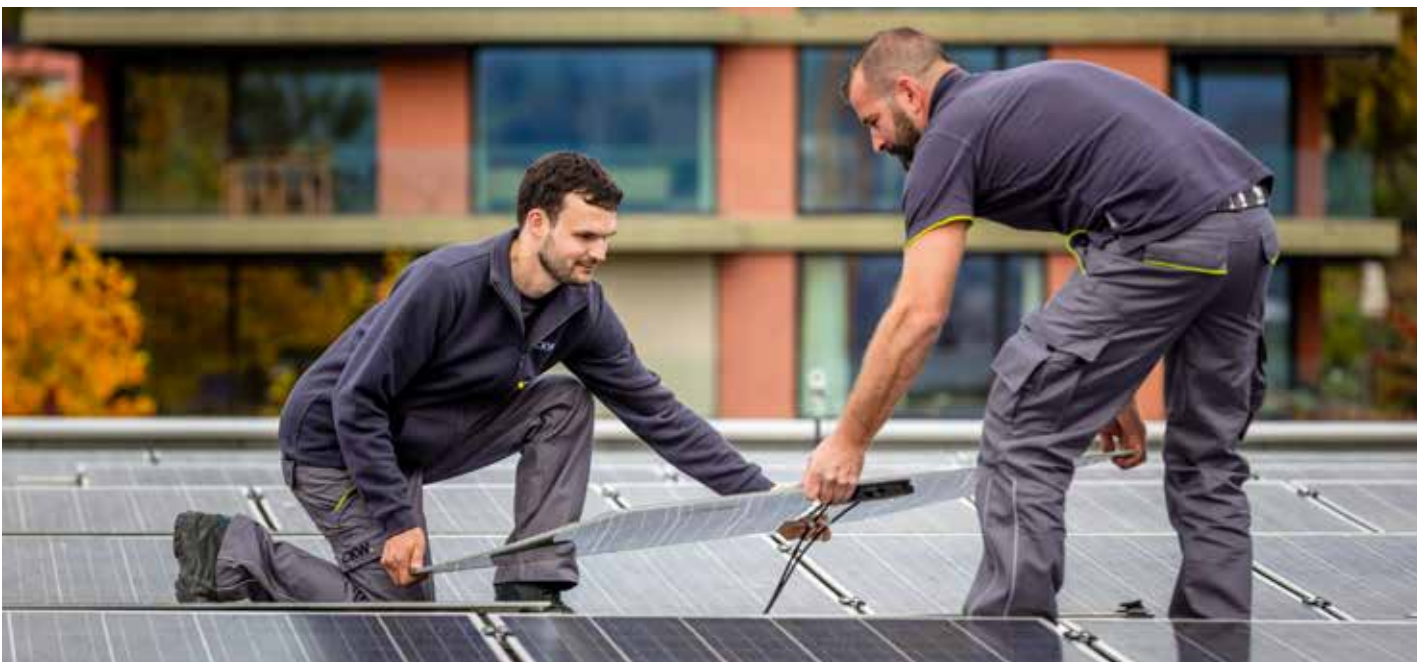
Ganzheitliche Lösungen aus einer Hand: Dazu gehören Planung, Installation und Wartung.
