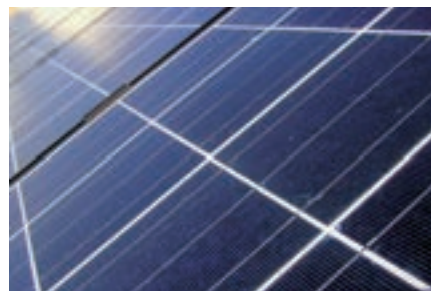
Photovoltaik – Anlage auf Werkstattdach der Garage
