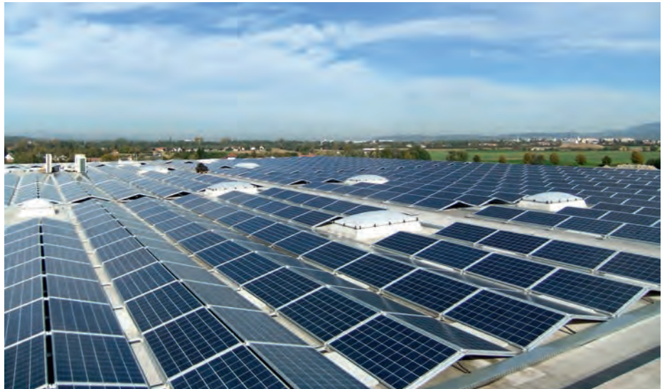
Allein über dieses Dach in Allschwil mit 3575 Quadratmetern Fläche und 1518 Modulen speist PrimeEnergy 39 Megawatt (MW) ins Netz ein.
