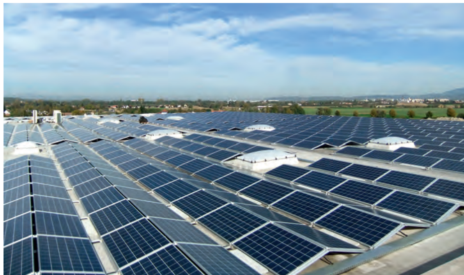
Allein über dieses Dach in Allschwil mit 3575 Quadratmetern Fläche und 1518 Modulen speist PrimeEnergy 39 Megawatt (MW) ins Netz ein.
