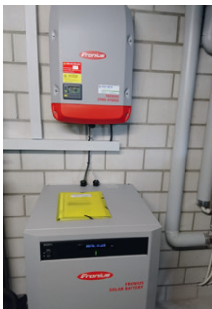
Der Energiespeicher puffert die Sonnenenergie bis sie verbraucht wird.
