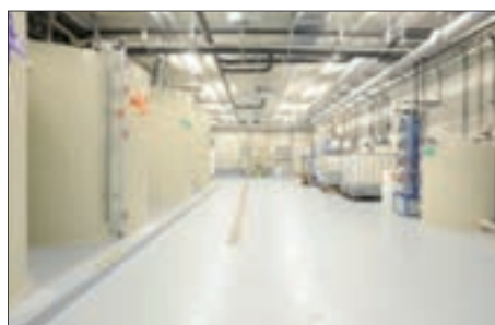
Frisch- und Abwasseraufbereitungsanlage
