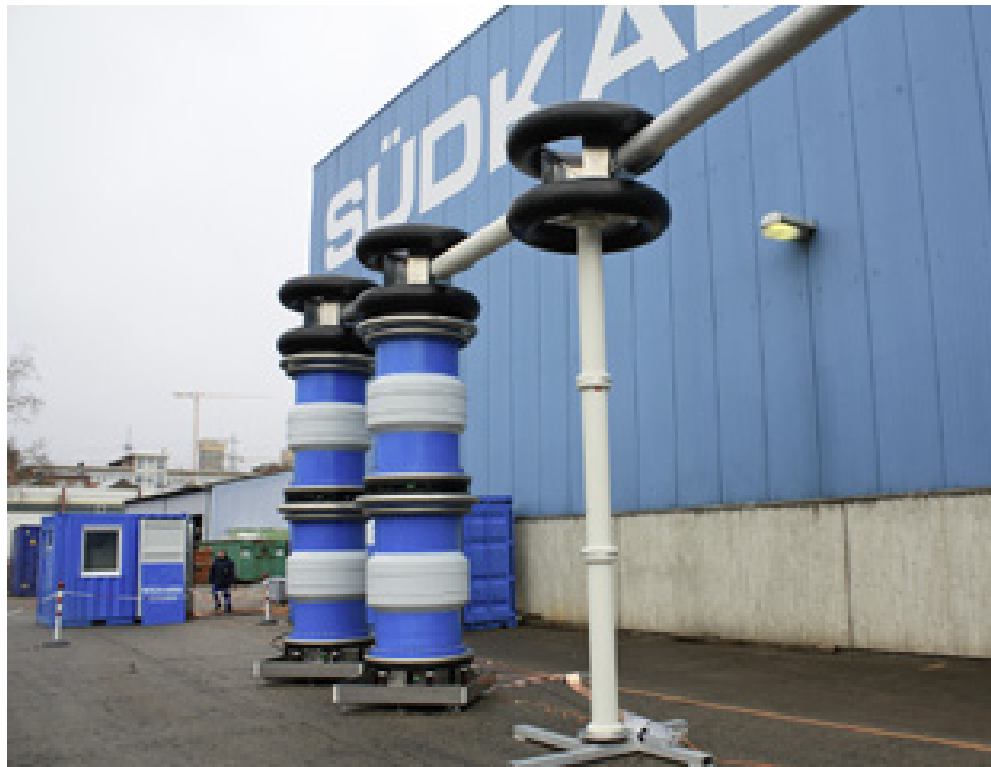
Die Vor-Ort-Prüfsysteme der agea-kull ag aus Derendingen sind weltweit sehr gefragt. Im Bild eine Resonanzanlage für 540kV zur Hochspannungskabel-Prüfung.
