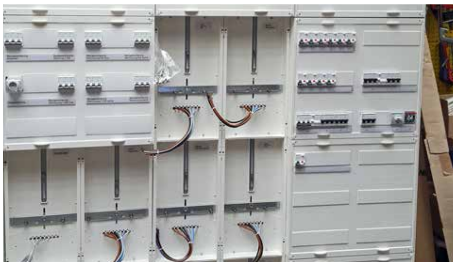
Wir bauen unsere Schaltanlagen selber
