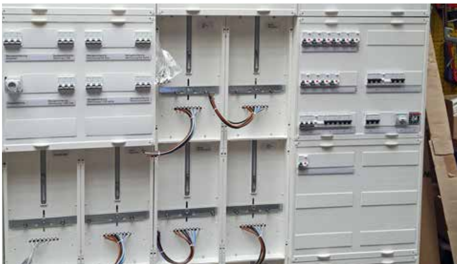
Wir bauen unsere Schaltanlagen selber.
