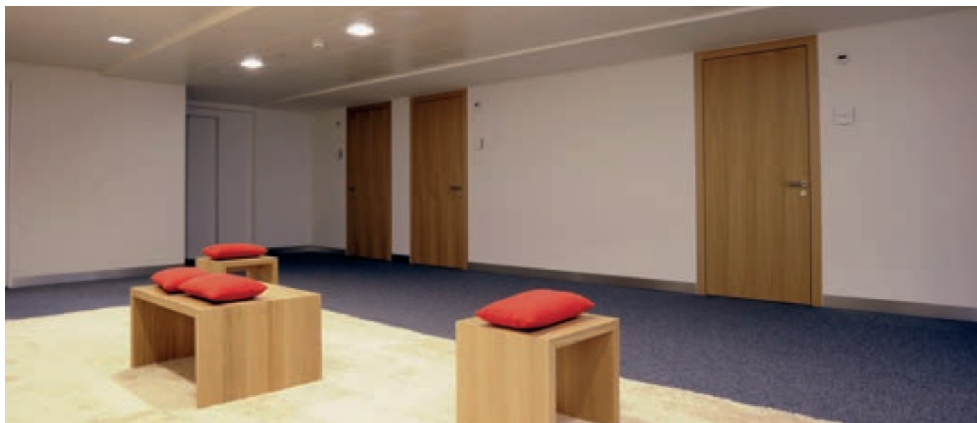
Schallschutz- / EI30- Türen im Empfangsbereich einer Bank.
